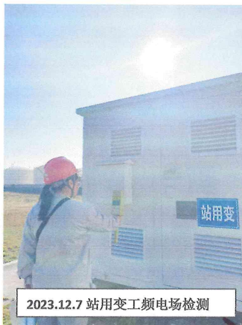
2023.12.7 箱式变压器工频电场检测
