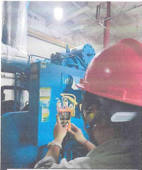
2023.11.17 螺杆制冷压缩机氨检测
