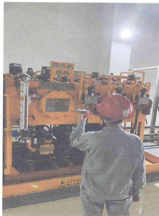
检测日期：2023.11.21 液压油站噪声检测
