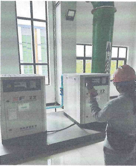
2023.9.13 一期空压机噪声检测
