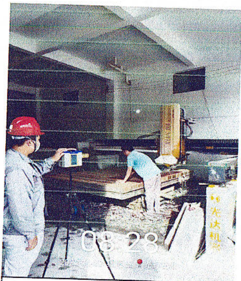
切割操作位粉尘检测
