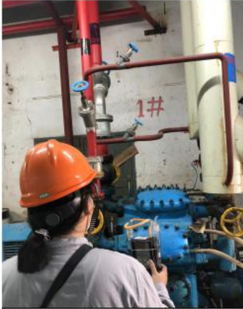
制冷压缩机 氨检测 2021-12-17
